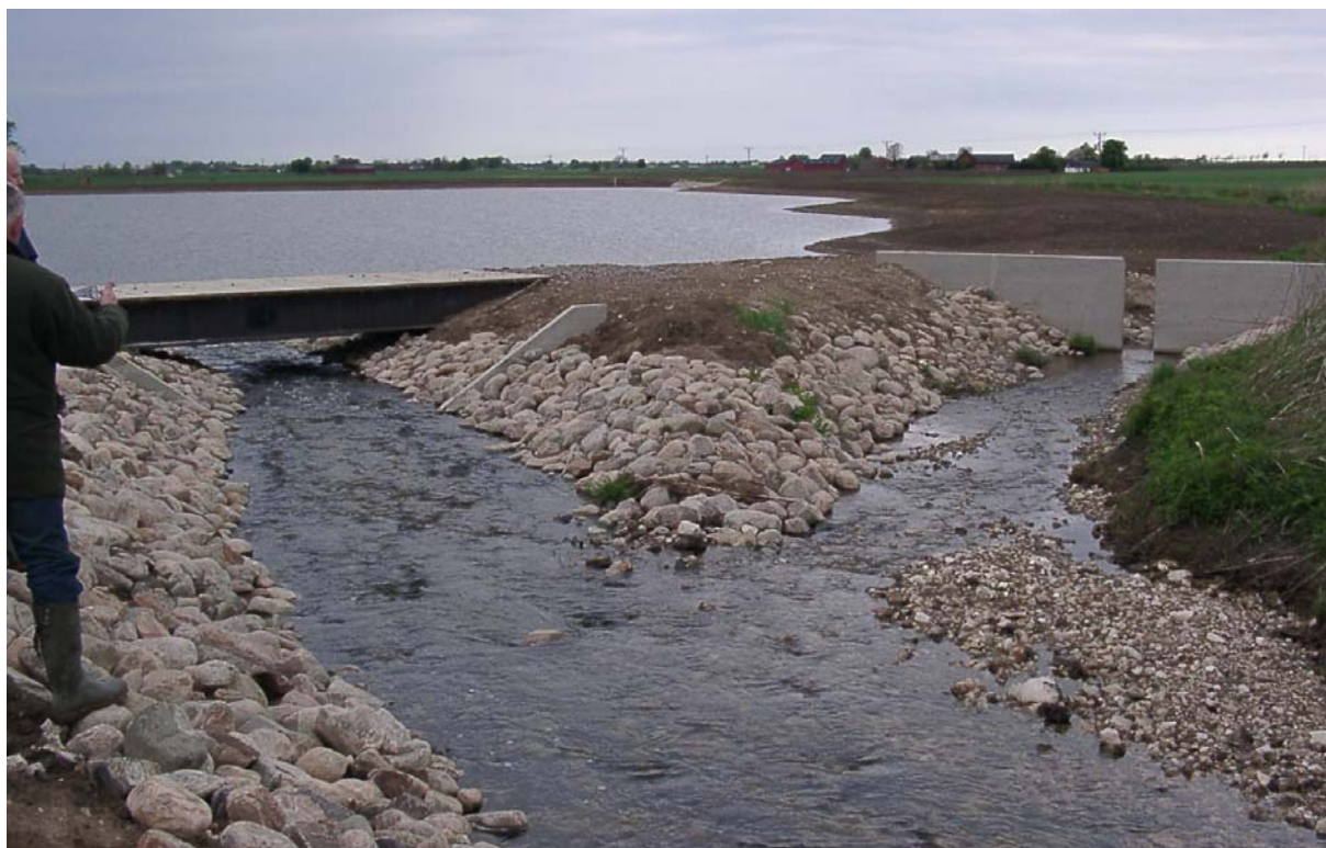
Figur 11. Sidoanläggning med öppet inlopp. En spalt i vattendraget gör att högflödena tvingas in i dammen medan de lägre flödena inte hindras att rinna förbi dammen. Projekt 62, nedströms Dalby reningsverk.
